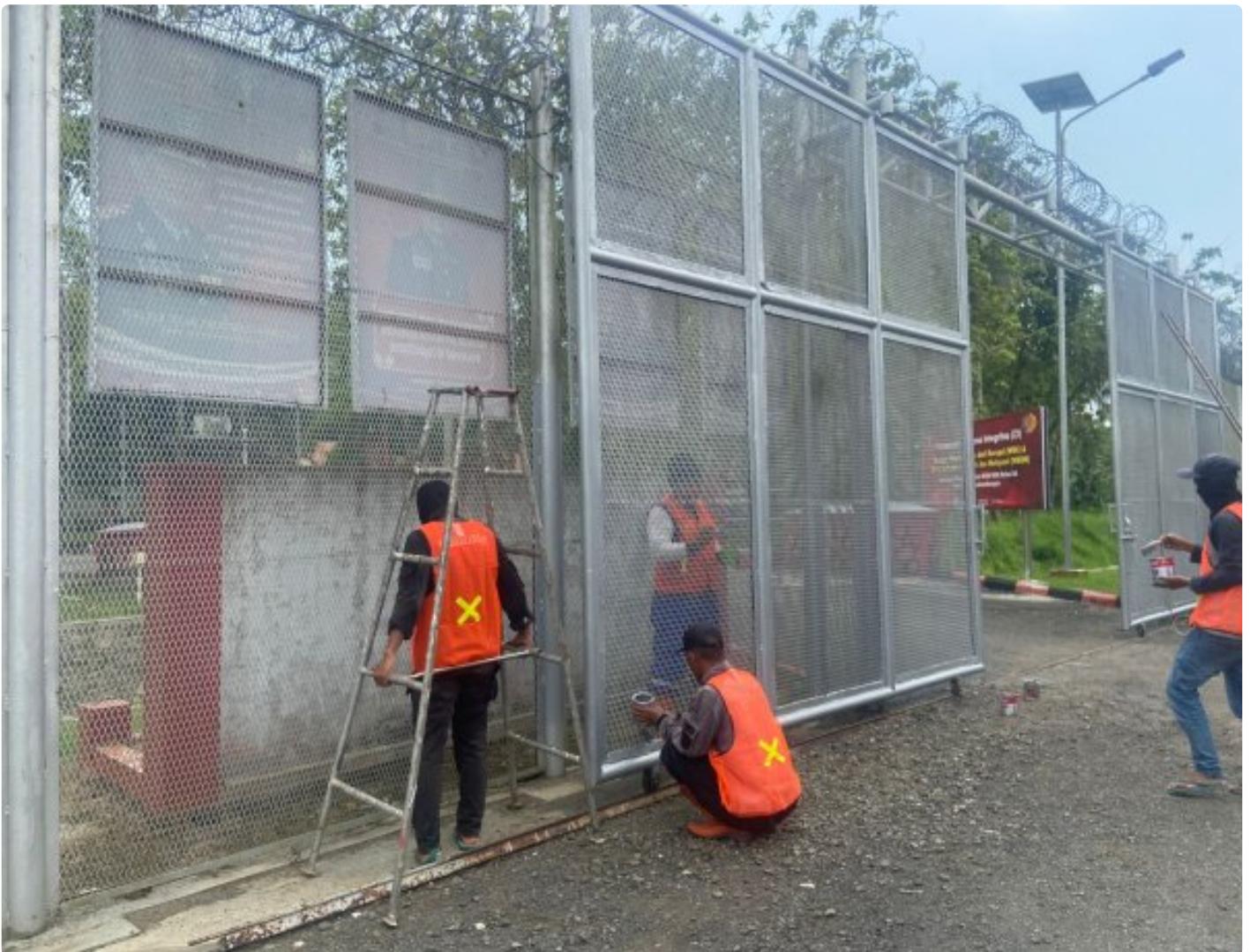
Pengecatan bangunan dan pagar Lapas Pasir Putih dalam rangka sambut HBO ke-59
